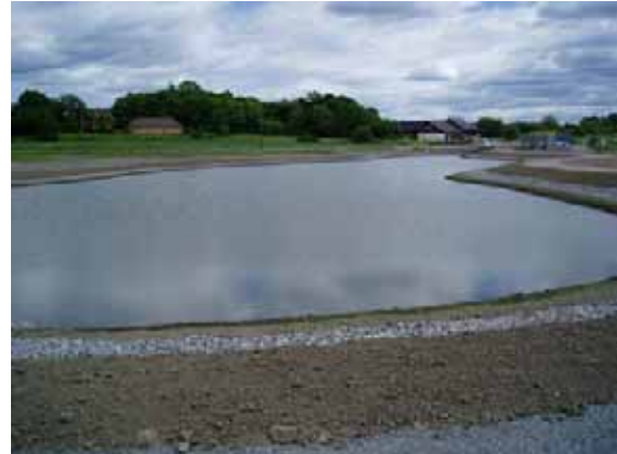
Figur 2. Åtgärdsplats 1, vid Fysingen. Blivande reningsanläggning för dagvatten under byggnation, juni 2004. Foto: Kent Hård, ALcontrol
