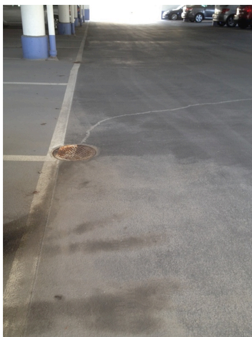
Figur 15: Dagvattenbrunn vid en parkering med behov av oljeavskiljare
