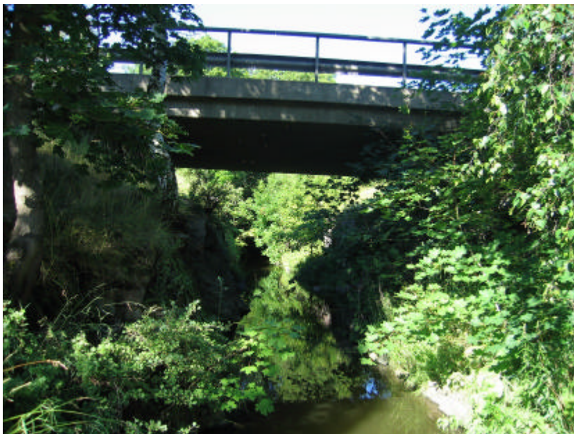
Prioritering 3: punkt 1, Hagbyån (Sandavägen). Landbrygga saknas under mycket trafikerad väg. Värdefull åsträcka med rik vattenföring mellan två av avrinningsområdets största sjöar.
